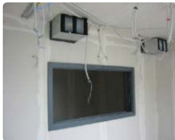
Silenbox para conductos de ventilación entre locutorio y control en emisora de radio
