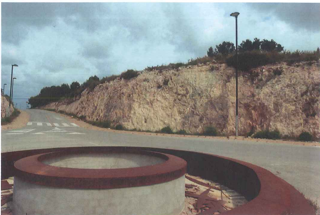
Fotografia 13. Vista d'uns talussos de la urbanització, formats per les calcàries bioclàstiques de la unitat NMe.
